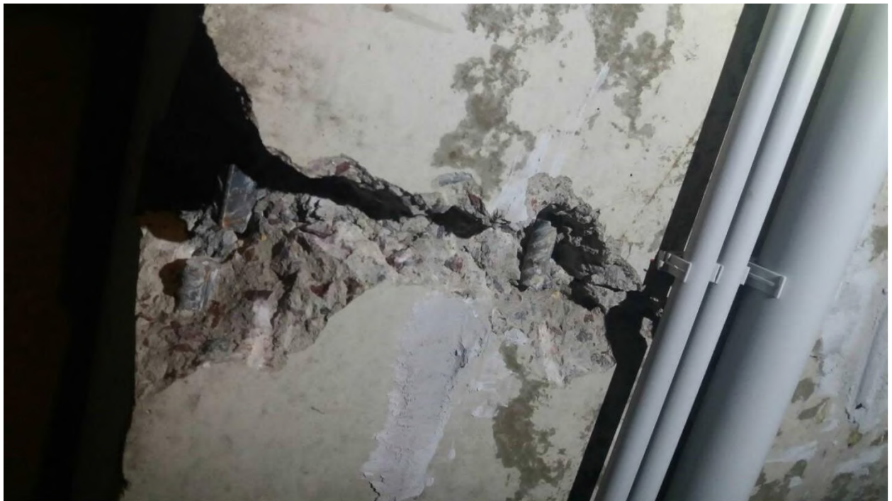
Рис. 4. Вскрытие продольной рабочей арматуры главной балки по оси Г/1 в сечении с характерной нормальной трещиной в зоне максимального положительного момента посередине пролёта 13/1-14/1
