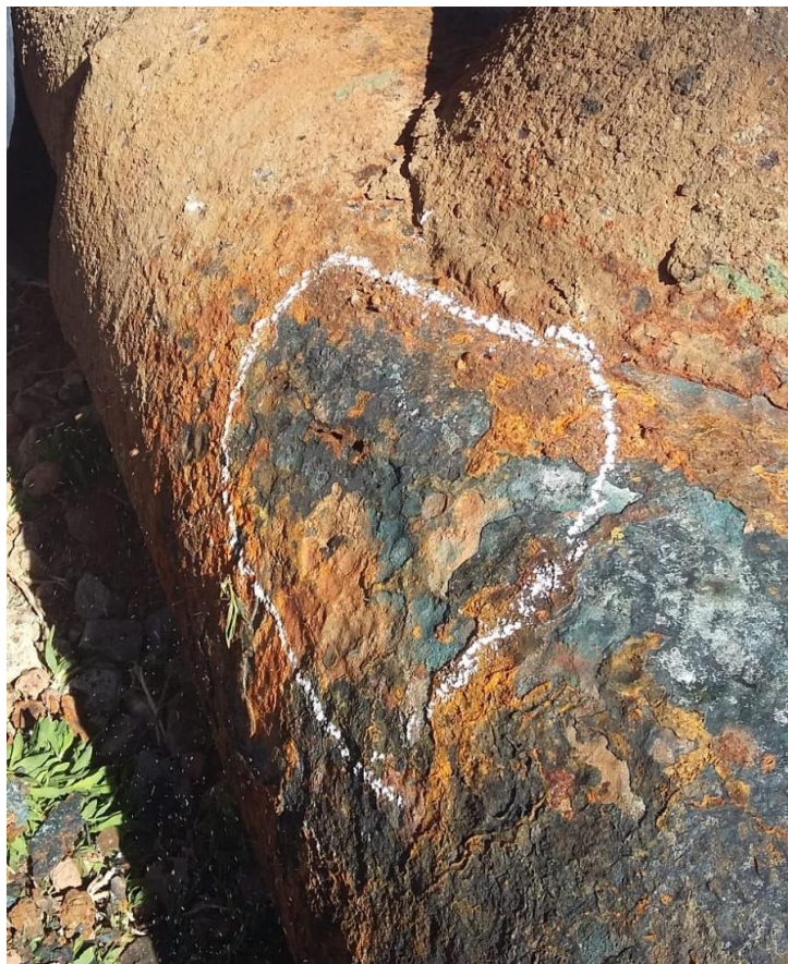
Рис. 1. Локальное коррозионное повреждение металлической конструкции трубопровода
