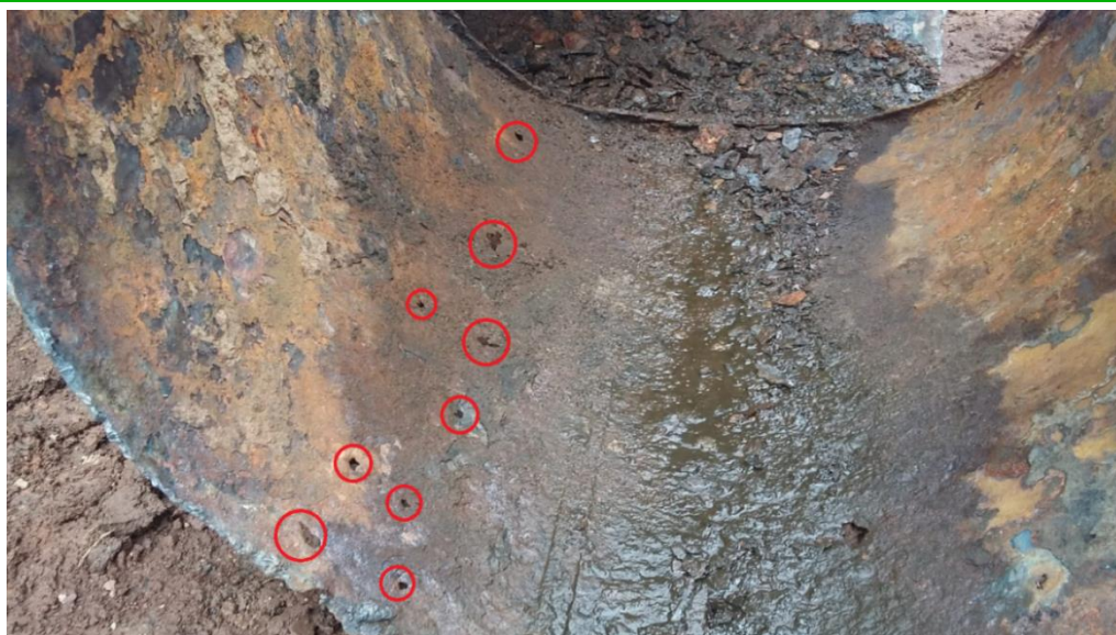
Рис. 3. Множественные очаги электрохимической коррозии на поверхности металлоконструкции
