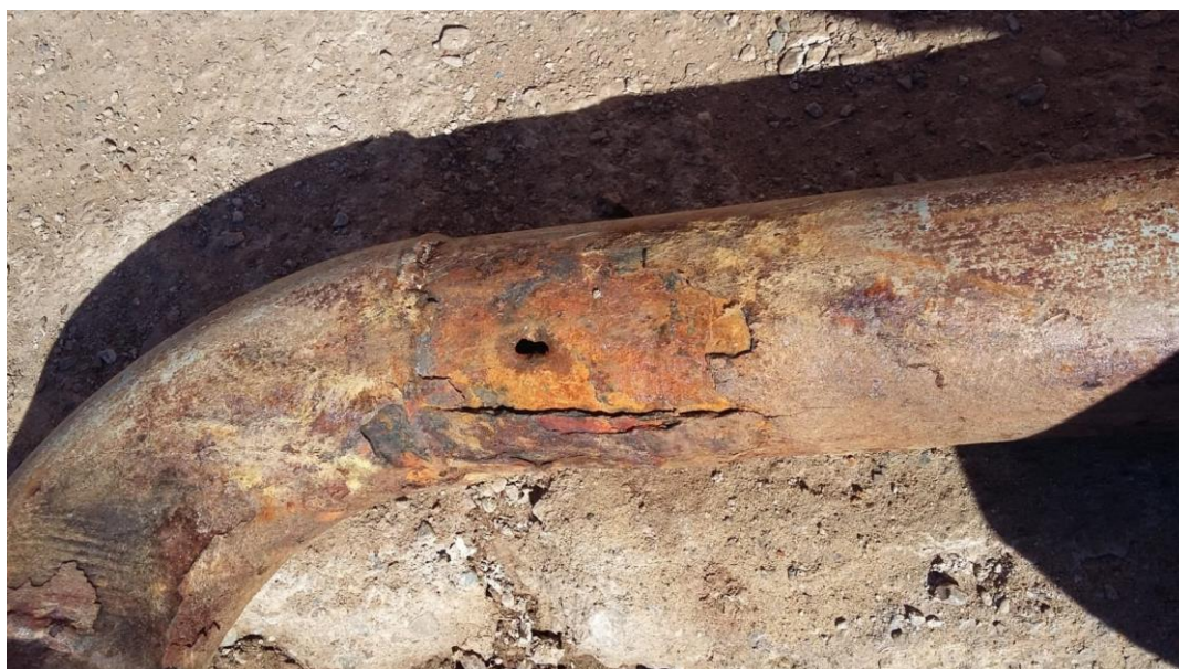
Рис. 2. Сквозное разрушение металла трубопровода в зоне повреждения защитного покрытия
